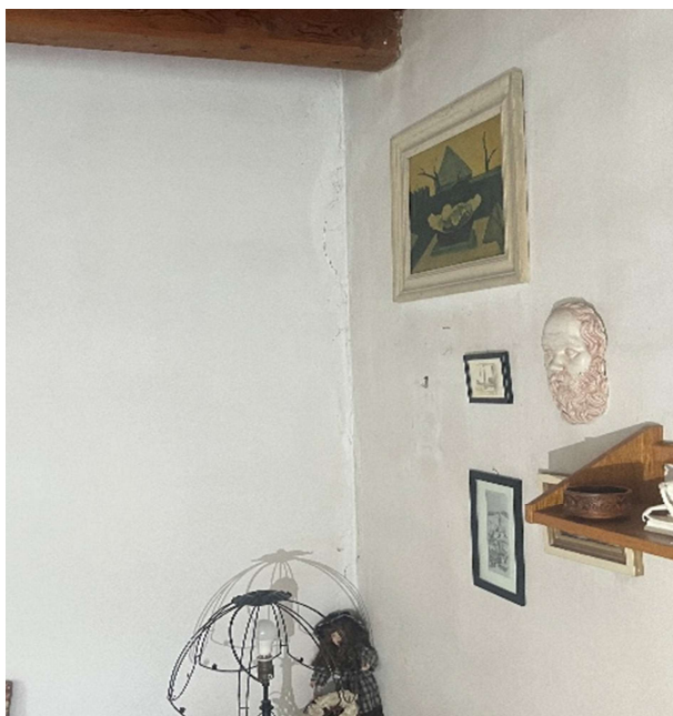
Trhlina mezi stěnami v rohu
