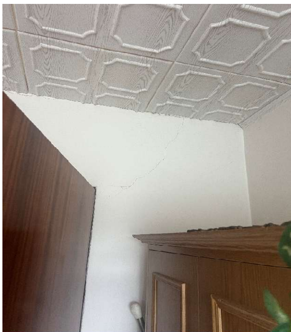
Trhlina ve stěně
