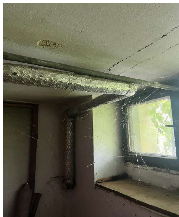
Trhliny ve stropní konstrukci nad 1.NP
