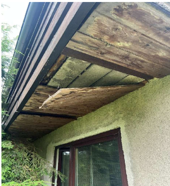
Odpadající záklop balkonu
