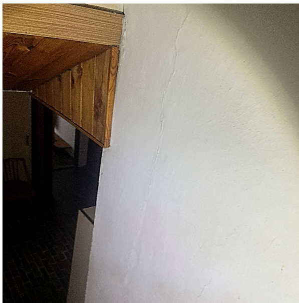
Trhlina ve stěně u komína
