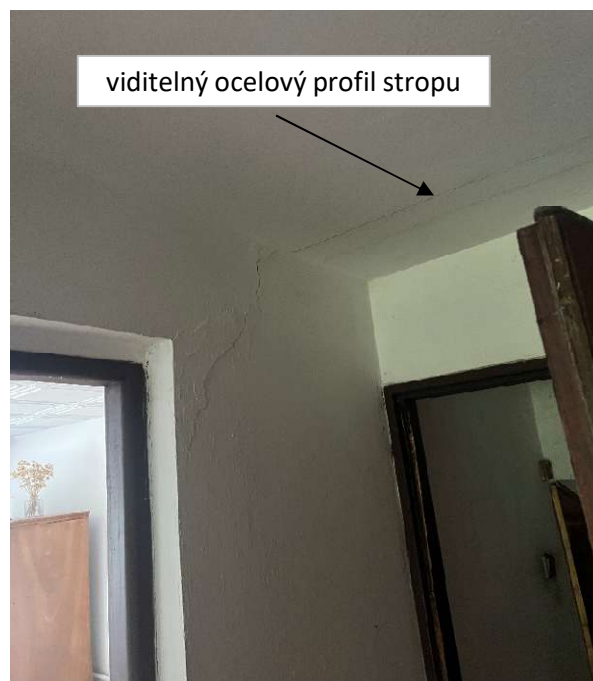
Trhlina v nosné stěně 1.NP - b
