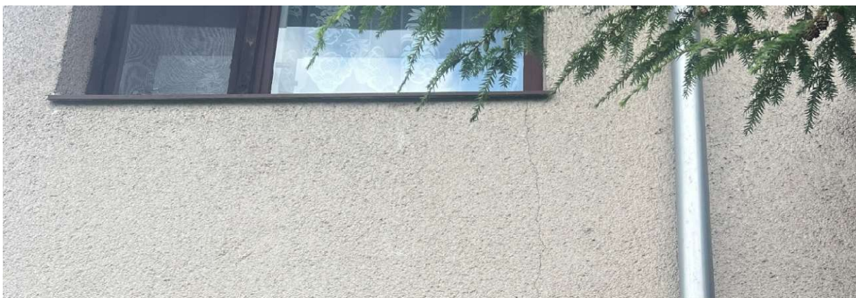
Trhlina v parapetu 2.NP
