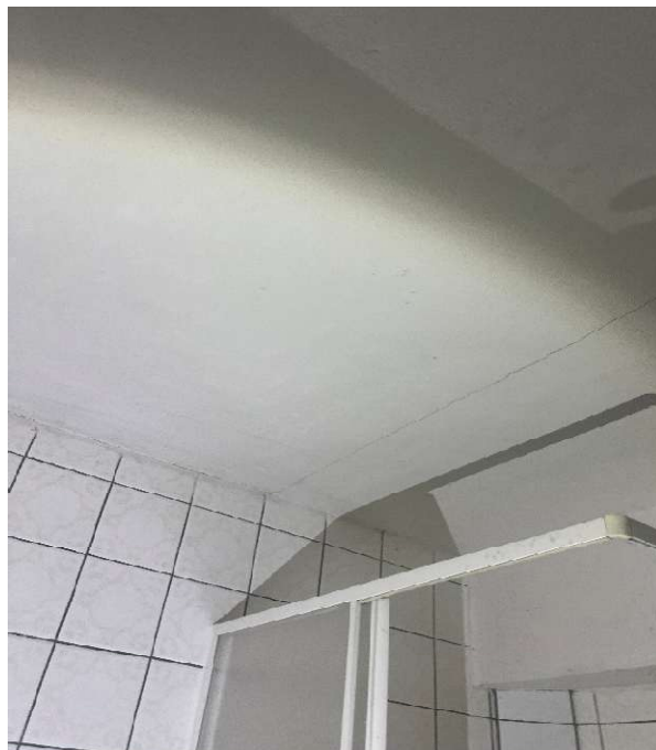
Trhliny ve stropní konstrukci nad 1.NP
