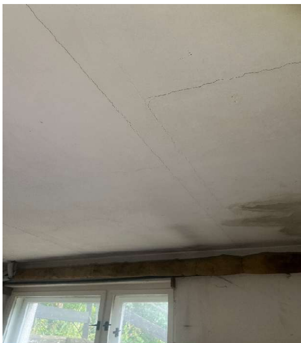
Trhliny ve stropní konstrukci nad 1.NP - garáž
