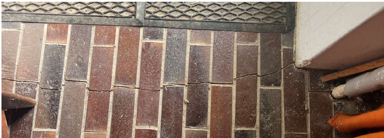
Trhliny v podlaze 1.NP
