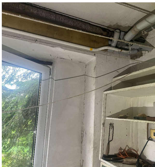
Trhlina mezi stěnami bývalé garáže
