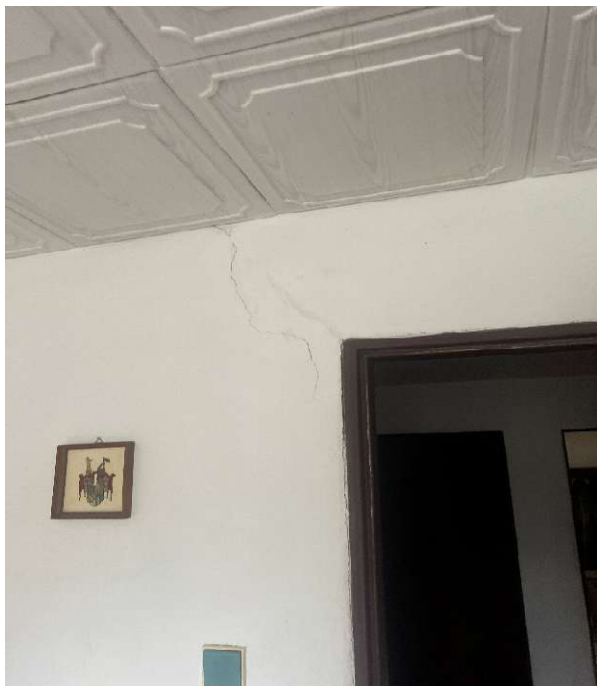
Trhlina v nosné stěně 1.NP - a
