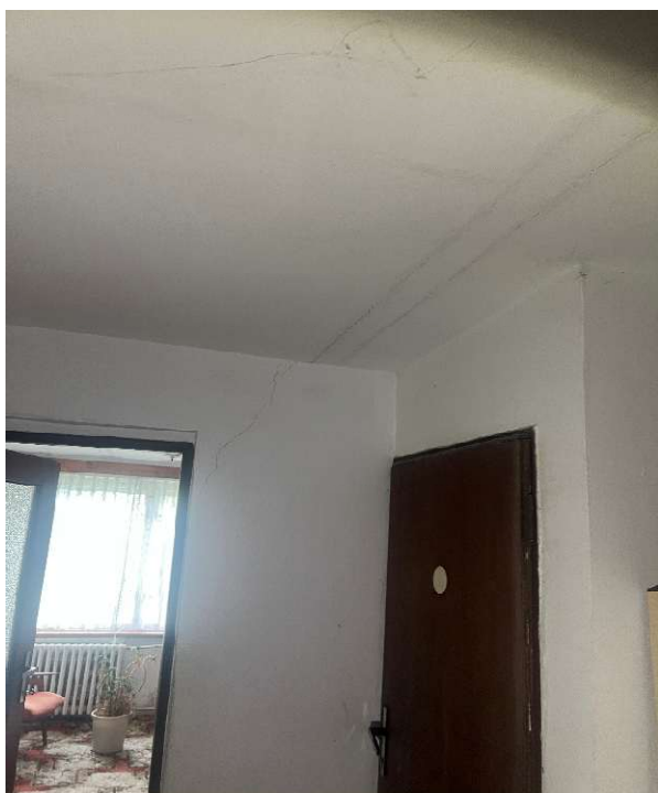
Trhliny ve stropní konstrukci nad 1.NP
