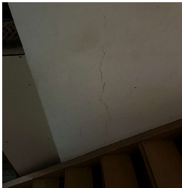
Trhlina ve stěně u komína
